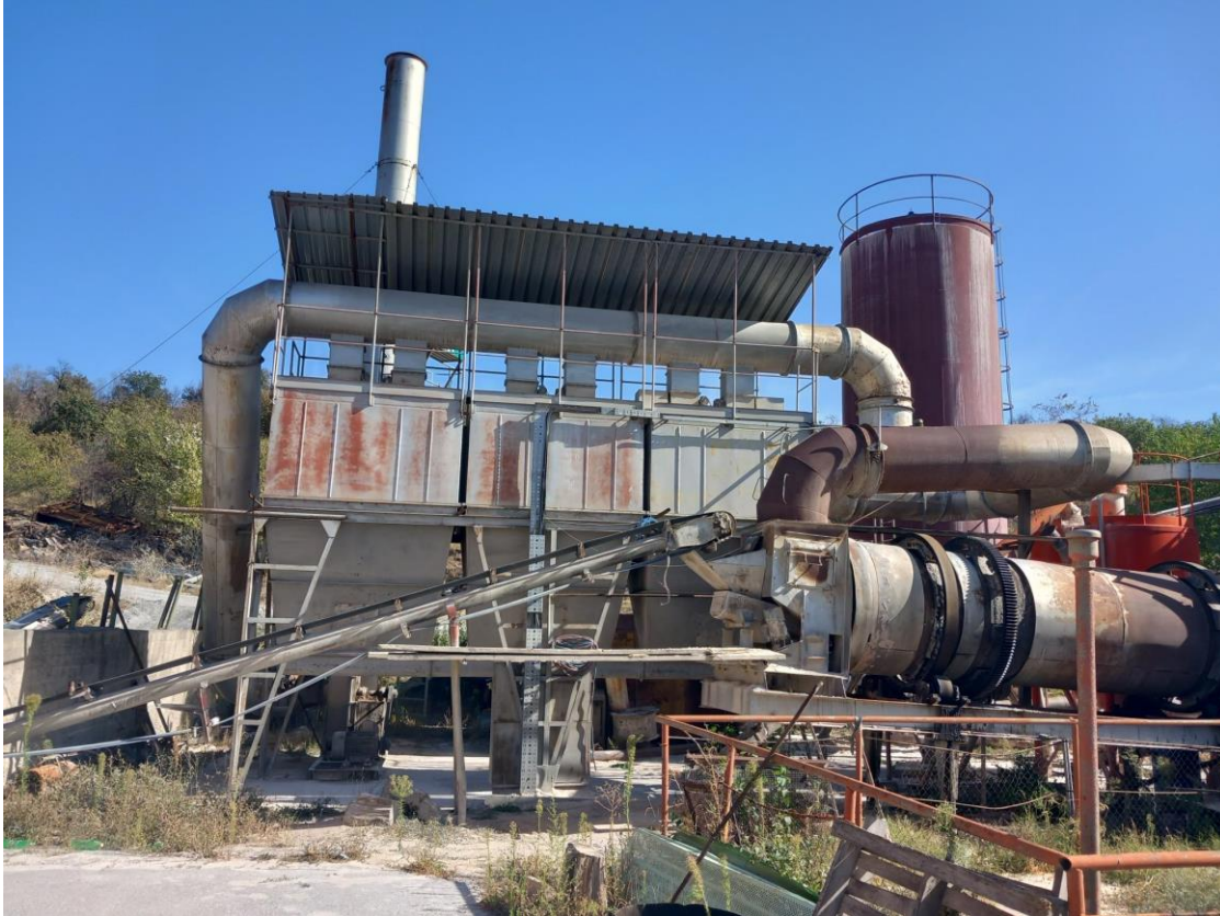
Слика II.4. Асфалтна база – Подружница Велес при ЈП за одржување и заштита на магистралните и регионалните патишта – Скопје ц.о. Проектиран капацитет: 30 t/h.
