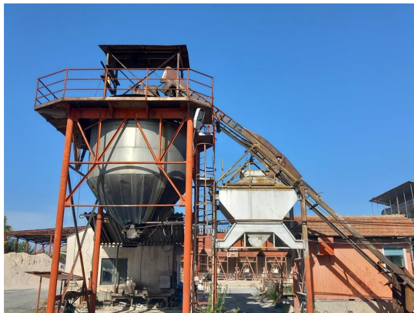
Слика II.17. Силос за складирање со дозатор за полнење камиони за транспорт на готов асфалт.
