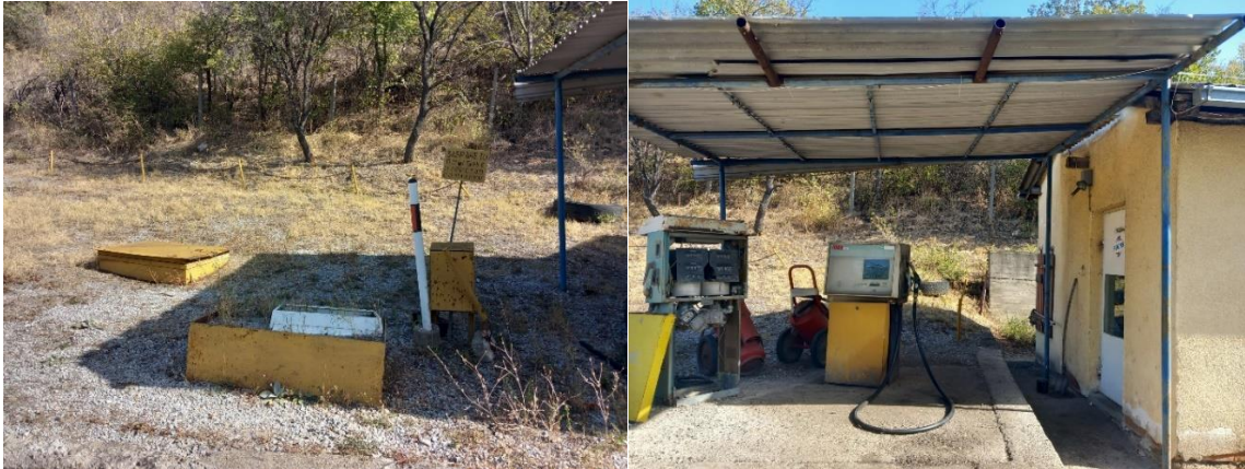
Слика II.15. Подземен резервоар за складирање на гориво Еуроодизел БС и пумпа за точење.
